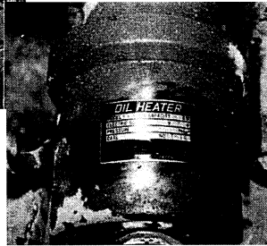
写真7.8 設定温度調整部
